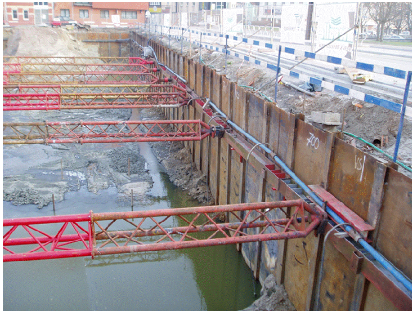
Soutènements – Problèmes typiques: Paroi berlinoise en présence d'eau:
